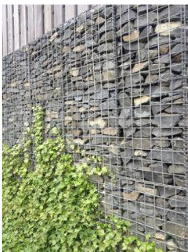
Rysunek 10. Przykładowa fotografia izolacji za pomocą ściany z gabionów porośniętej roślinnością pnącą
